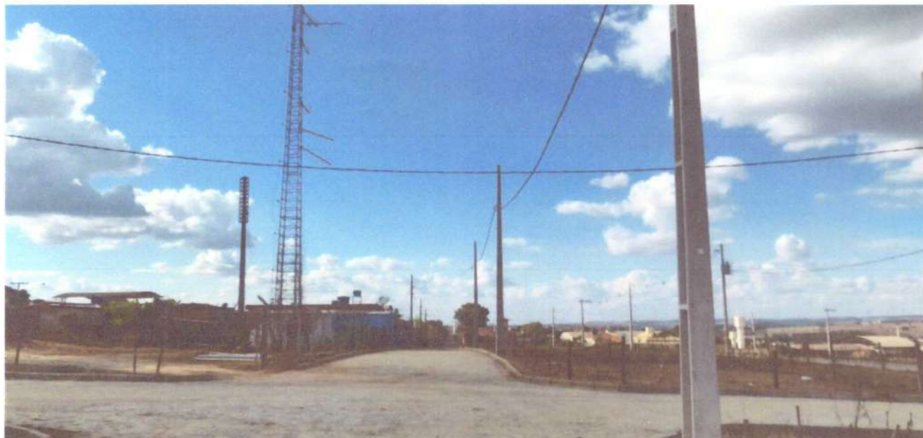
Foto 04: instalação de poste no loteamento Therezinha Albieri de Sousa – Rua Joao Rodrigues Sobrinho.
